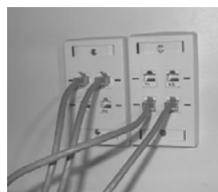
Tomada de rede embutida na parede
