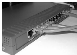
Detalhe da conexão dos cabos no hub
