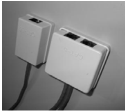
Tomadas de rede em caixas externas.
